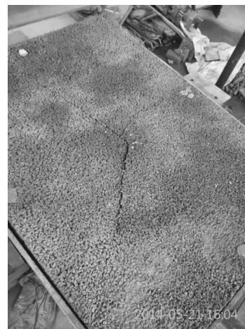
图 7 干燥土基层透水混凝土面层裂缝形态
